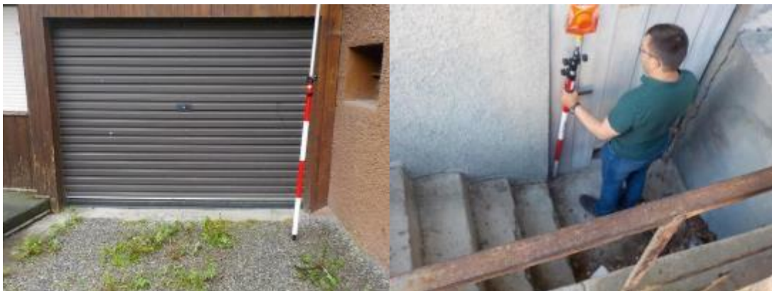
Abbildung 23: Betroffene Gebäudeöffnungen: links – Garagentor Obere Talwiesen Nr. 17; rechts - Kellertür Obere Talwiesen Nr. 15
