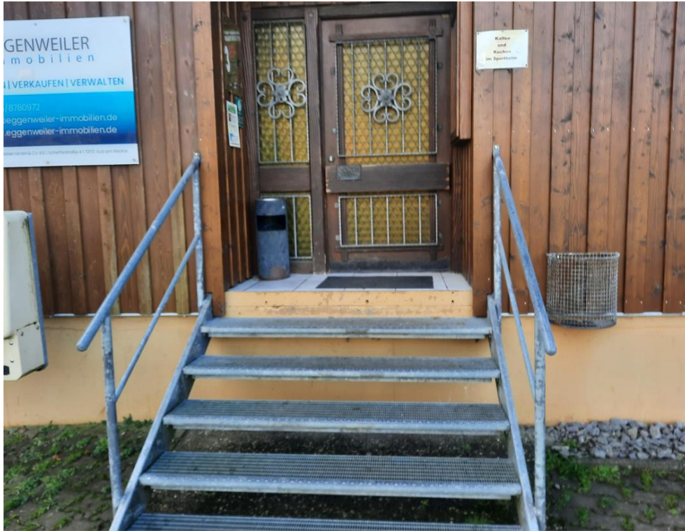
Abbildung 24: Betroffene Eingangstür am Sportheim
