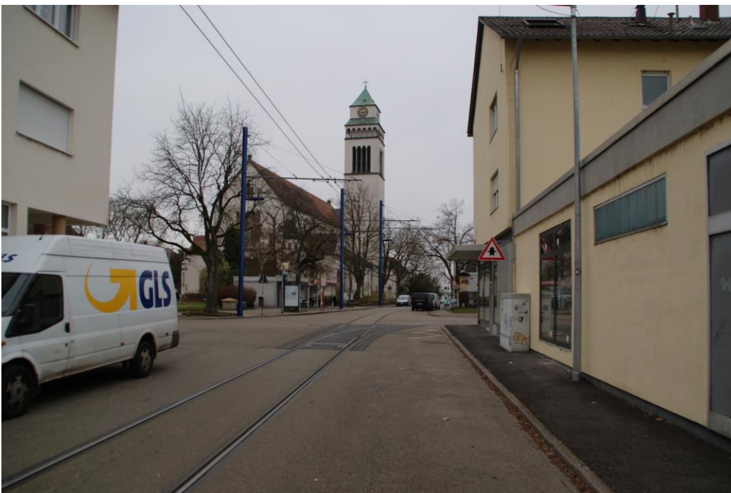
Abbildung 22: Kastenwörtstraße – Neubau (Maststandort K!4-K15-K16)
