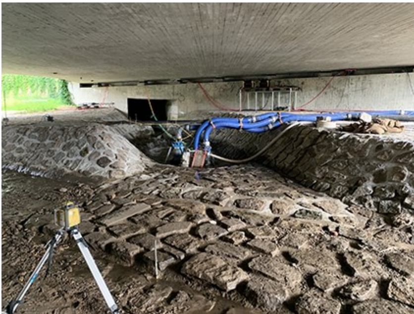
Der neu errichtete Grundelbachkolk (Copyright WALD + CORBE Consulting GmbH) Der neu hergestellte Grundelbachkolk wirkt einer Erosion der Weschnitzsohle durch erhöhte Abflüsse des Grundelbachs entgegen. Auf dem Bild sind die Pumpen zu sehen, mit denen der Grundelbach umgeleitet wurde. Auch das neu hergestellte Böschungs- und Sohlpflaster ist zu sehen.
