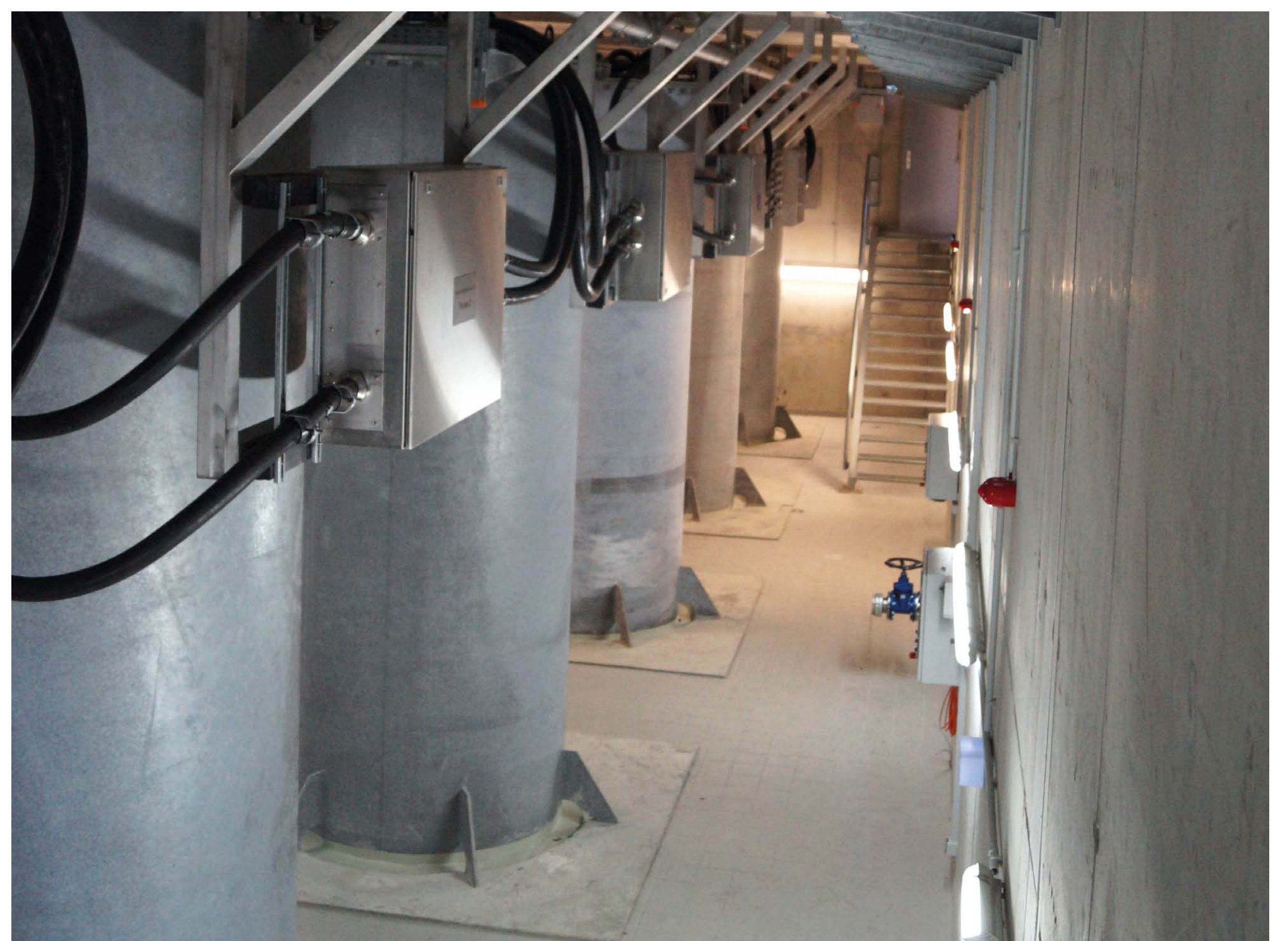
Ein Blick ins Innere des Schöpfwerks
