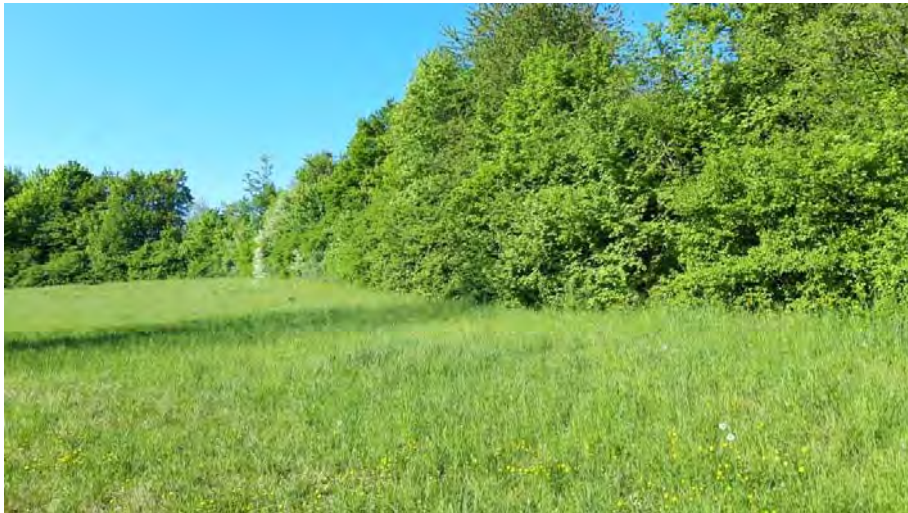
Abb. 13: Die Böschung an der Bundesstraße B 14 ist durchgängig bewachsen
