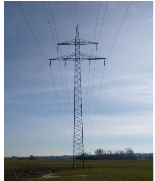
Abbildung 14: Mast 5 (Tragmast) der bestehenden 110-kV-Leitung Crailsheim - Jagstheim (Anlage 0409)
