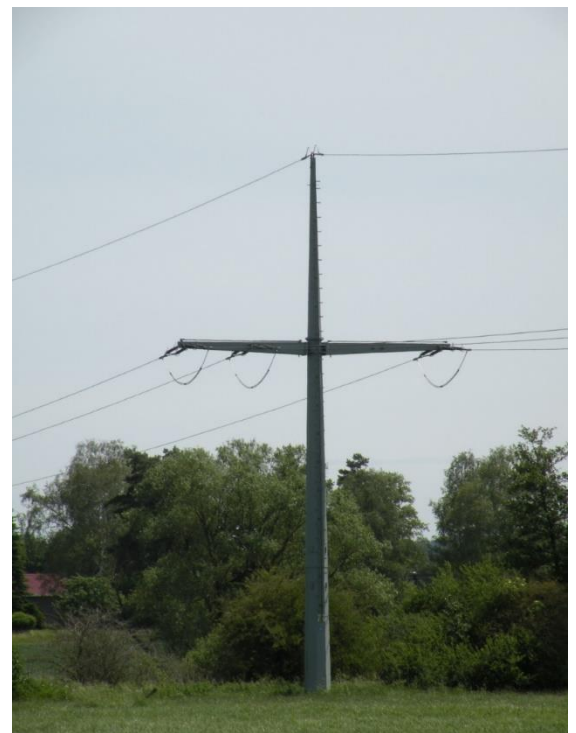
Abbildung 15: Mast 1 (Tragmast) der bestehenden 110-kV-Leitung Onolzheim - Crailsheim (Anlage 0410)
