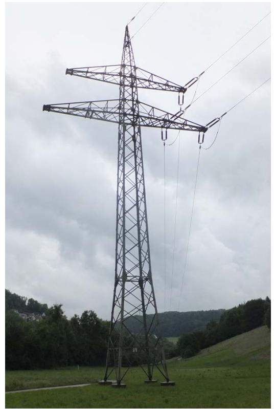
Abbildung 8: Mast 75 (Abspannmast, Donaumast) der LA 0109
