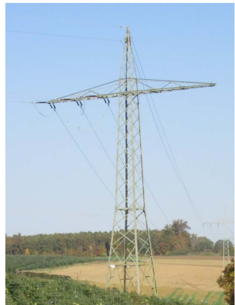
Abbildung 10: Mast 15 (Abspannmast, Einebenenmast) der LA 0108
