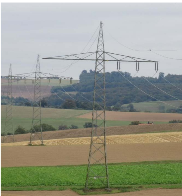
Abbildung 9: Mast 29 (Tragmast, Einebenenmast) der LA 0109
