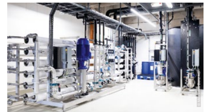
Mehrstufige Wasseraufbereitung bei der Mercedes-Benz AG.
