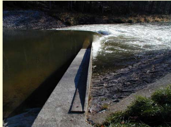
Vor dem Umbau: gefährlicher Absturz
