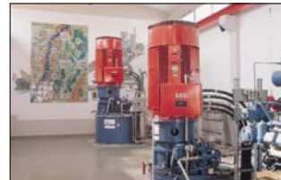
Im Schöpfwerk fördern die vorhandenen Pumpen bis zu 26 m³ Wasser pro Sekunde.
