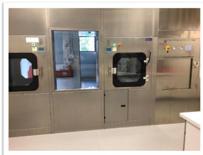
Abbildung 12: Begasbare Durchreichen im BSL3-Labor
