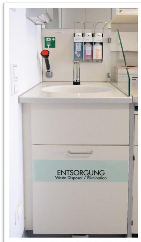
Abbildung 3: Abgetrennter Handwaschplatz mit Hygieneset, Augenspülvorrichtung und Einmaltuchspender
