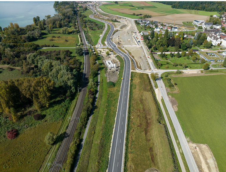
Das spätere Ostportal des Tunnel Hegne wird sich am unteren Bildrand befinden
