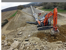
Sieb- und Brecheranlage
