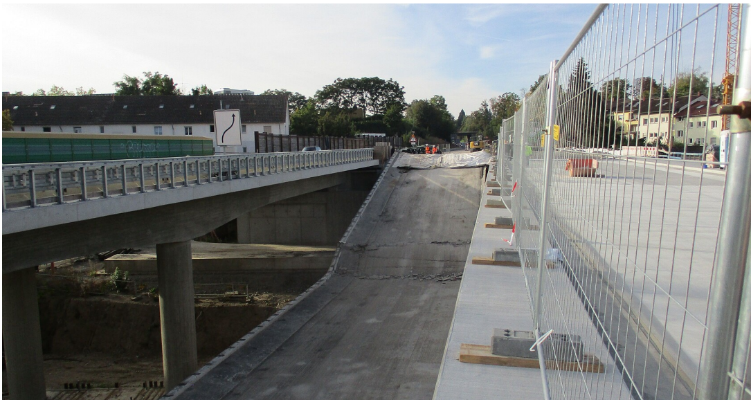
Gesprengte Brücke von oben
