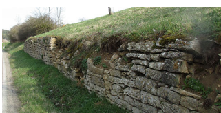
Natursteinwand vorher; Quelle: Regierungspräsidium Stuttgart
