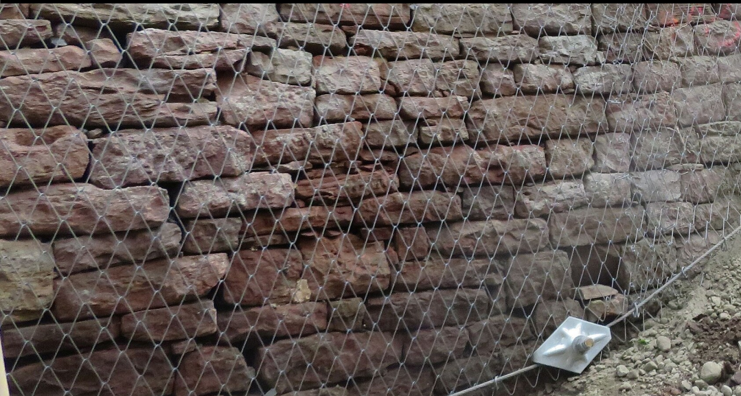
Drahtseilnetz mit Zugänglichkeit zum Mauerwerk für Reptilien
