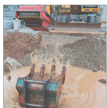
Absturz eines Anbauwerkzeugs (hier zur Illustration des Problems absichtlich durch Fehlmanipulation herbeigeführt)
