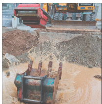
Absturz eines Anbauwerkzeugs (hier zur Illustration des Problems absichtlich durch Fehlmanipulation herbeigeführt)
