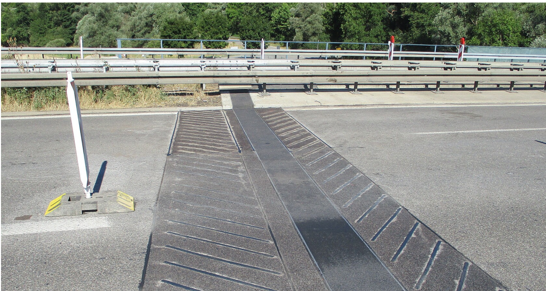
Neue Übergangskonstruktion auf der Brücke über die Wiesaz bei Dußlingen in Fahrtrichtung Tübingen
