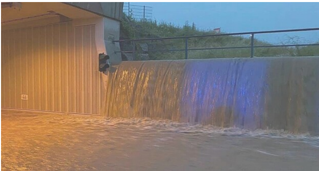
Überflutung des Dußlinger Tunnels
