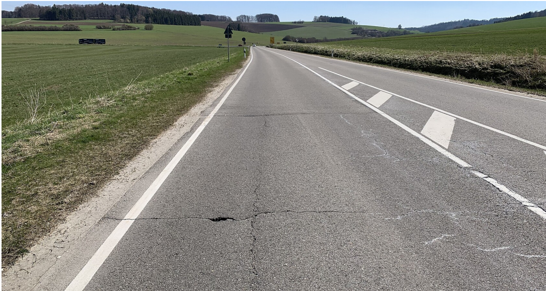
Fahrbahnschäden auf der B 28 zwischen Römerstein-Böhringen und Anschluss B 465
