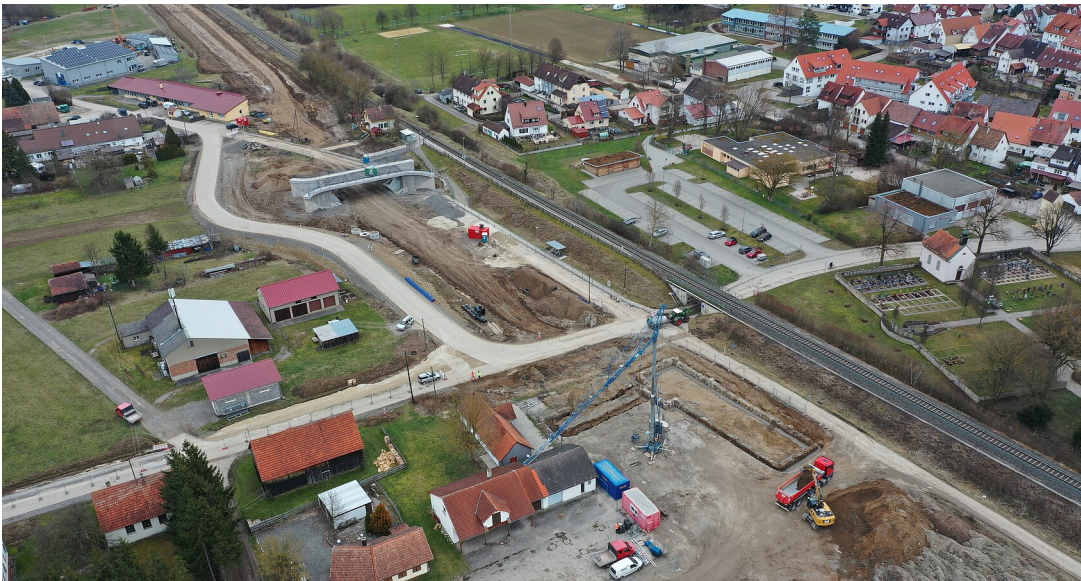
Luftbild von dem betroffenen Bereich der Neckarstraße in Rottenburg-Kiebingen
