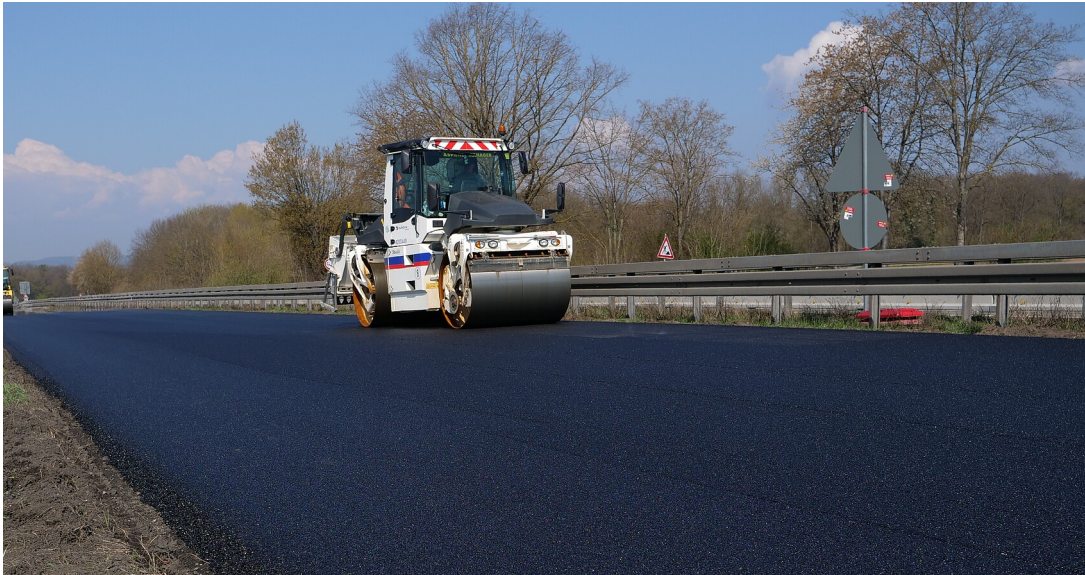
Symbolbild für eine Straßensanierung
