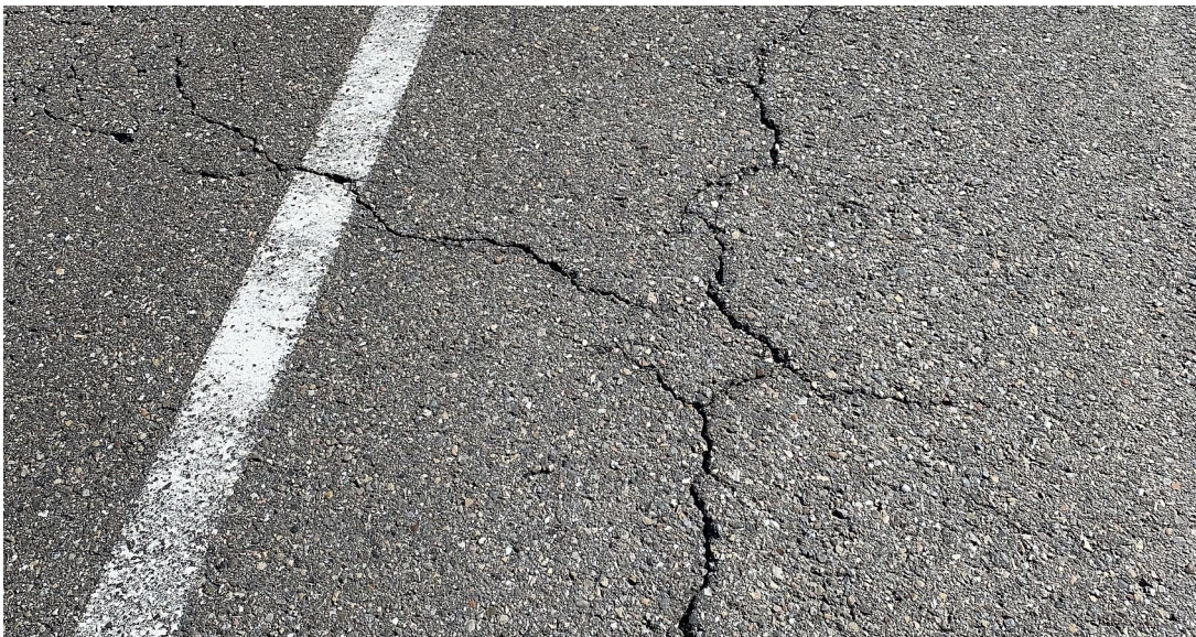
Schäden in einer Fahrbahndecke
