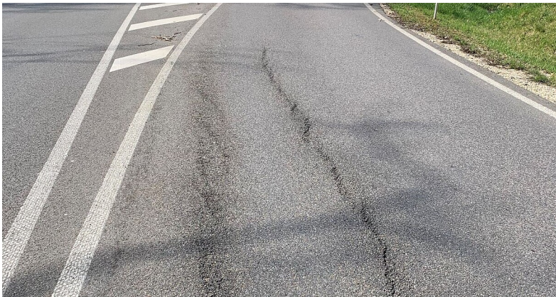
Schadstelle auf der Ortsumgehung Grafenberg im Zuge der B 313
