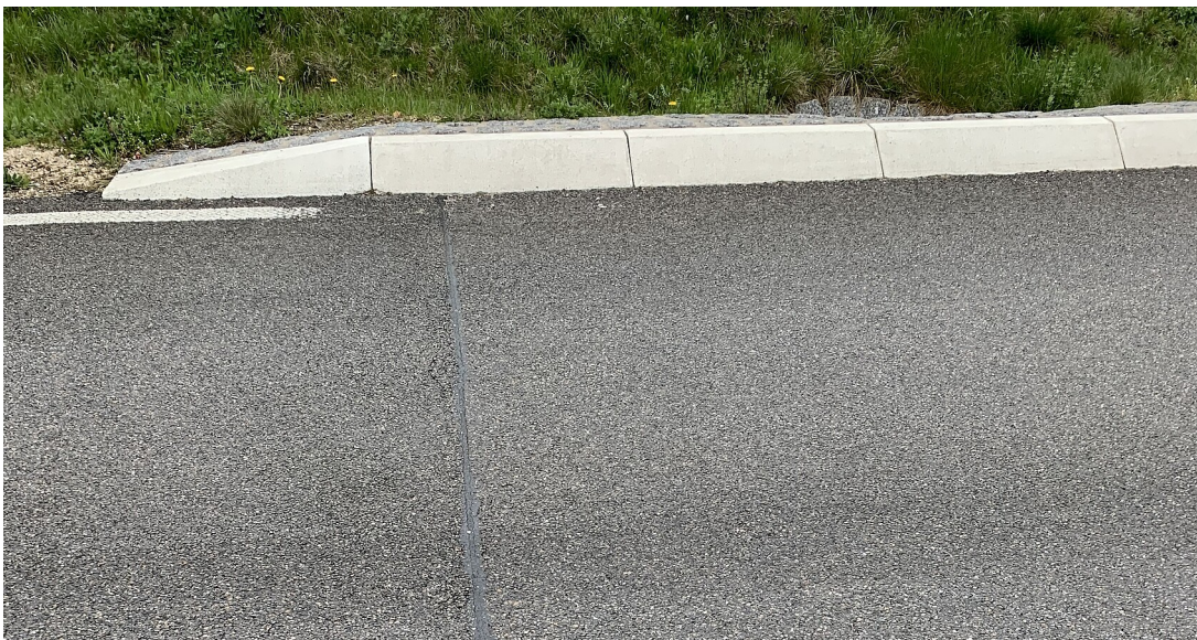
Schadstelle am nördlichen Kreisverkehr in der Ortsumgehung Grafenberg
