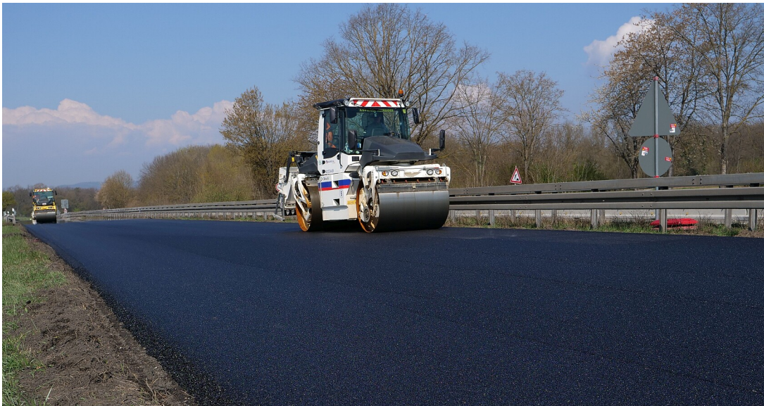
Symbolbild für eine Straßensanierung
