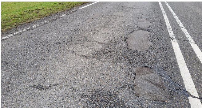
Schadstelle auf der Bundesstraße 32 zwischen Mengen und Hundersingen
