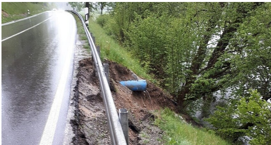
B 32 Böschungsrutschung zwischen Sigmaringen und Sigmaringendorf
