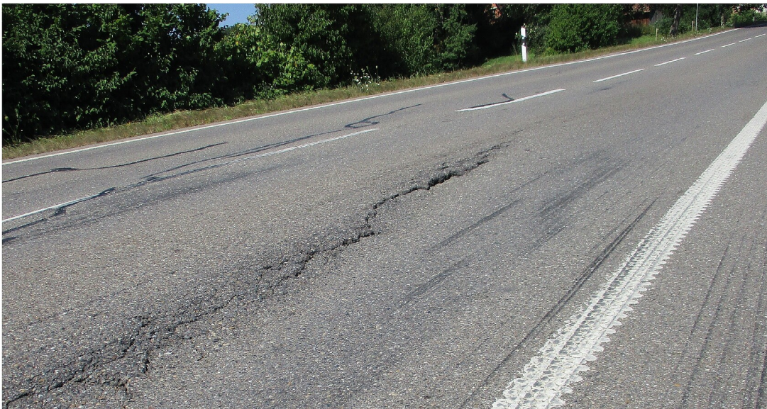
Schadstelle auf der B 32 bei Eichstegen-Hangen
