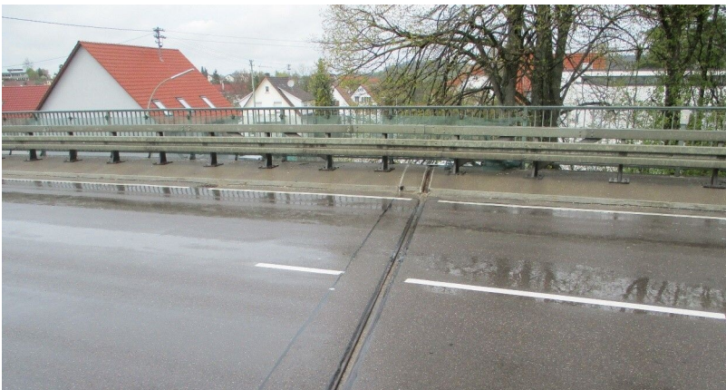
B 463 Übergangskonstruktion der Lochenbachbrücke bei Balingen-Weilstetten
