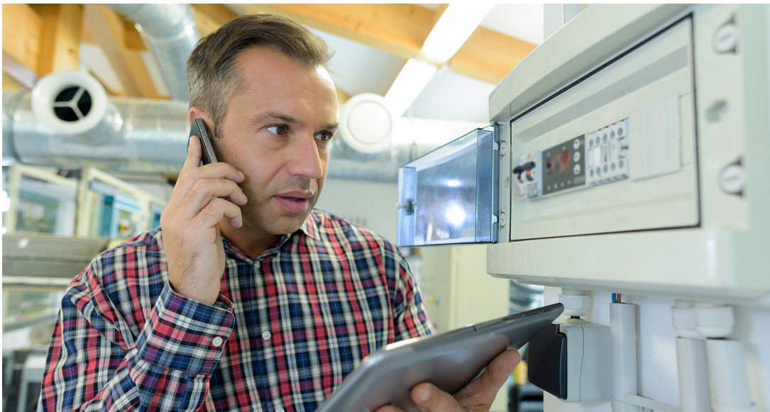
Kontrolleur beim Ablesen eines E-Zählers
