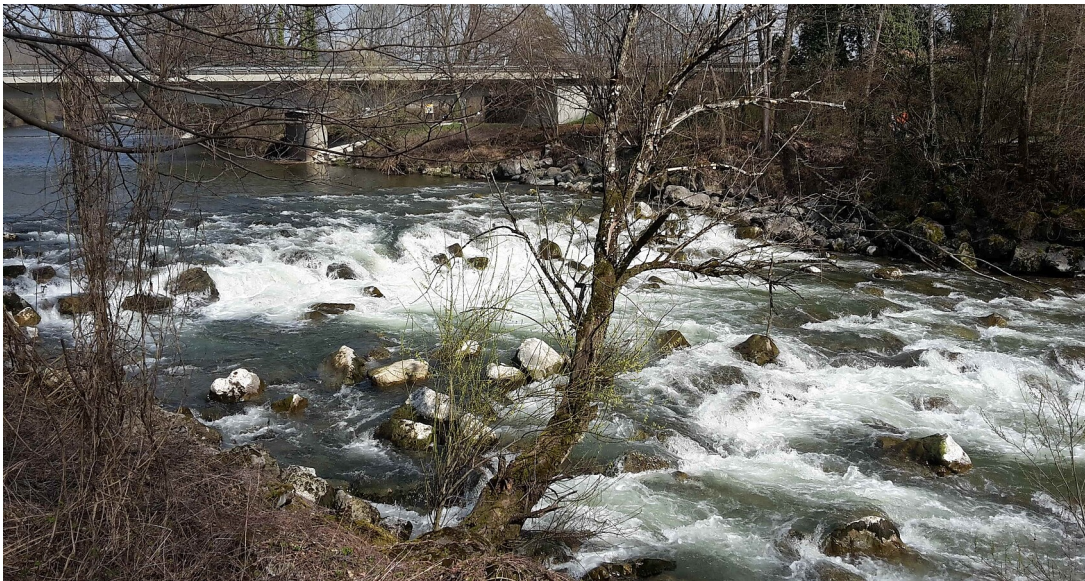
Sanierungsbedürftige Raue Rampe
