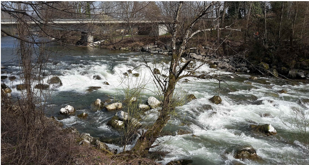
Sanierungsbedürftige Raue Rampe
