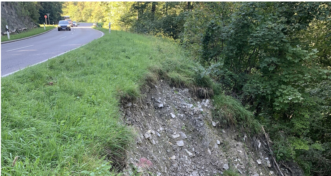
Hangrutsch an der Gönninger Steige im Verlauf der L 230
