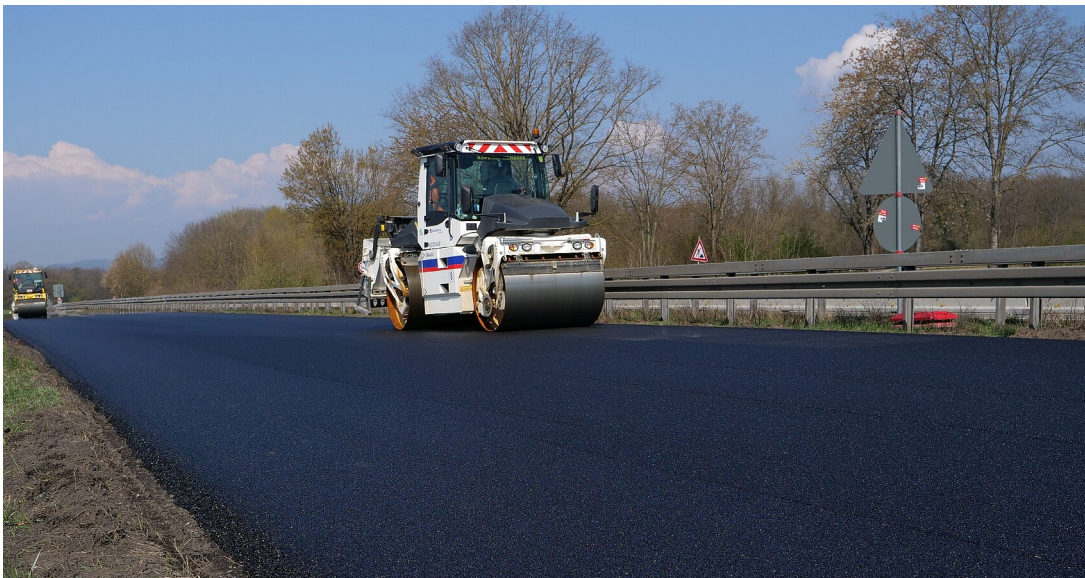
Symbolbild für eine Straßensanierung
