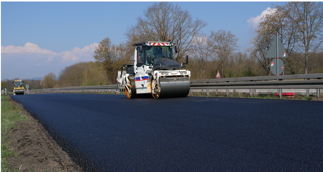
Symbolbild für eine Straßensanierung
