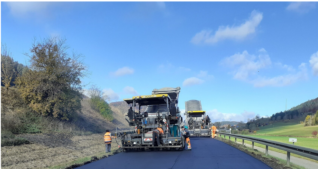
Symbolbild für eine Straßensanierung
