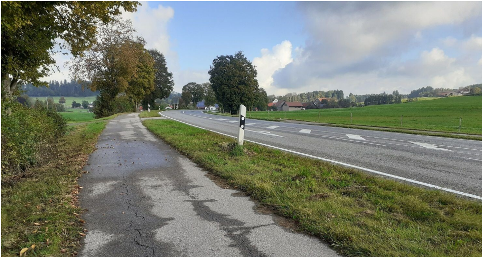
Schadhafter Radweg entlang der L 320 in Blickrichtung Oflings
