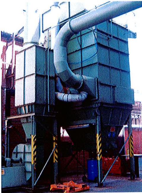
Die zentrale Filteranlage fängt alle anfallenden Stäube auf.
