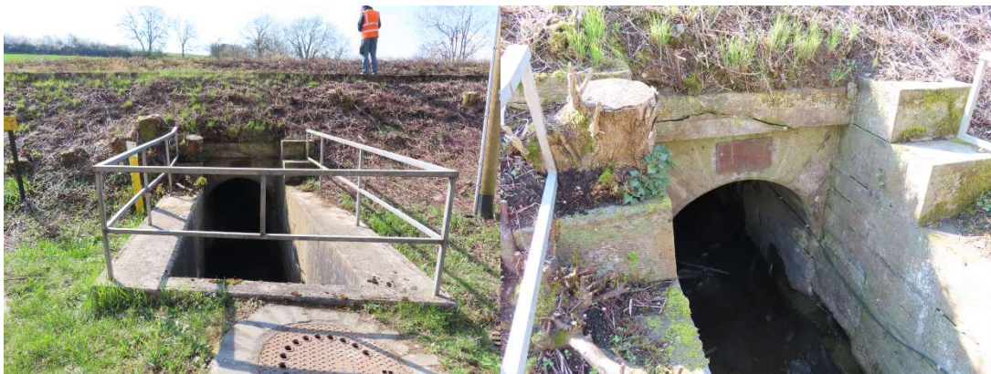
Abbildung 12: Durchlass Nr. 4 (Bilder r.d.B.)
