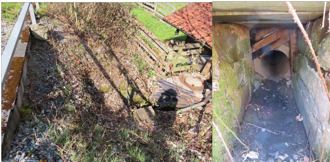
Abbildung 11: Durchlass Nr. 3 (Bilder r.d.B.)
